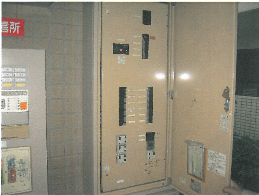
分電盤 点検（異常なし）
