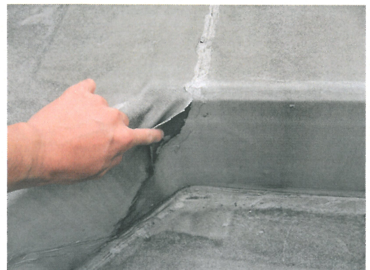
玄関ホール屋上 点検（ジョイント部劣化）
