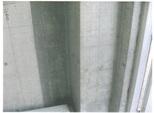
電気室 室値井点検（異常なし）
